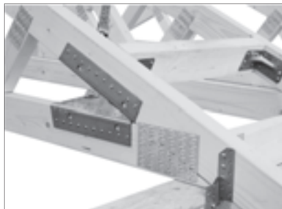
Detail am Traufpunkt: Bandanschlüsse BNG25 an Ober- und Untergurt eines Nagelplattenbinders befestigt.
